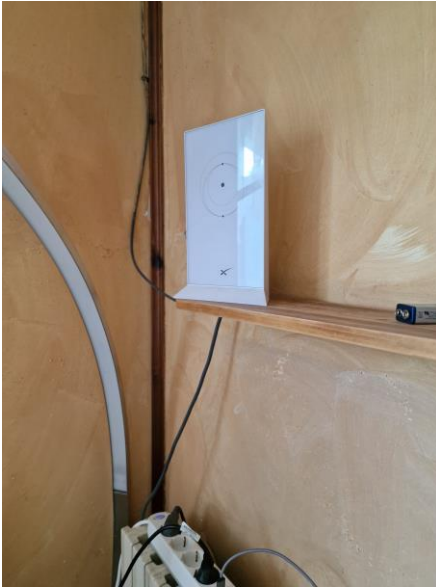
Starlink - diese Stromversorgung bleibt eingeschaltet.
